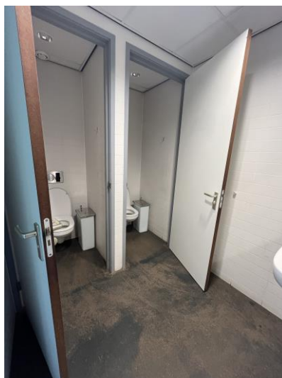
Toiletruimtes bij Palmenkas
